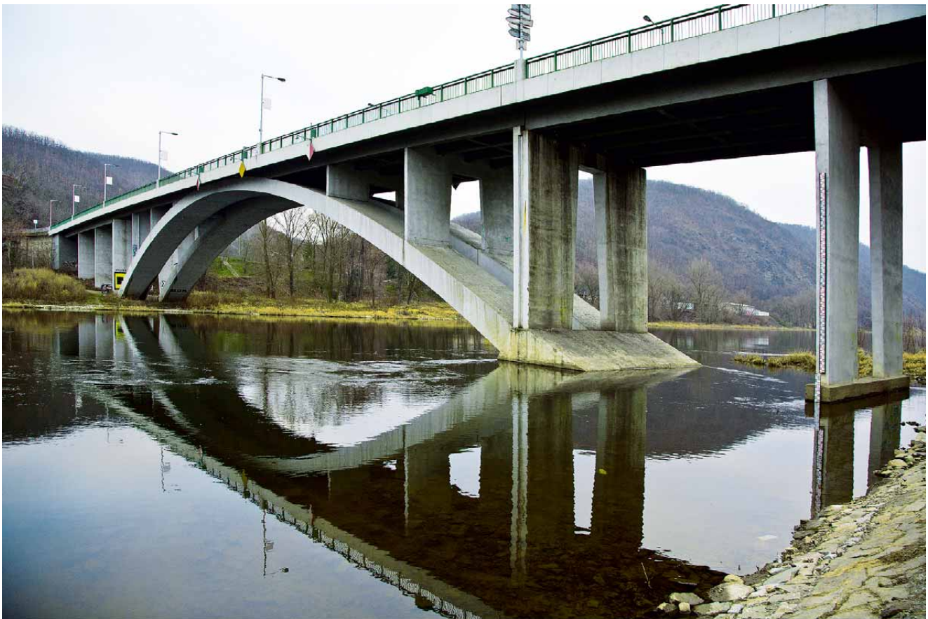
7 Most Závodu míru ve Zbraslavi. První obloukový most na světě postavený metodou samonosné svařované výztuže (bez potřeby bednění).
