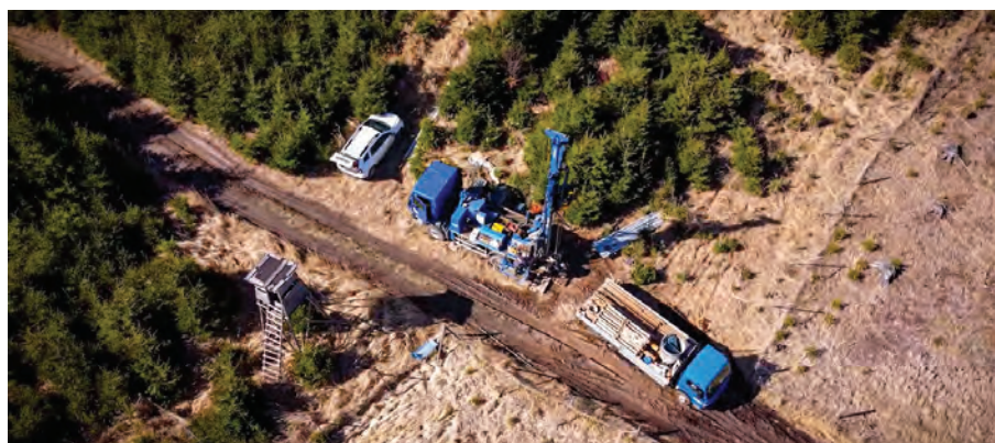
Na střežské D3 (58 km) proběhl v letech 2022-2023 náročný podrobný geotechnický průzkum zahrnující tisíce vrtů (v průměru 40-50 sond/na 1 km), a to až do hloubky 100 m. Na něj v tomto roce navazuje realizace průzkumových štol pro tunely Luka a Kamenná Vrata v celkové délce 3 km a průzkum pro most Sázava
