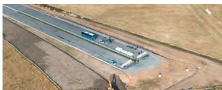
D3 0312/II Současný konec dálnice 383 m před hranicí. Dole ve výstavbě provizorní komunikace pro napojení do Rakouska (ŘSD 11/2025)
