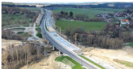
D3 0312/II Provoz je veden po novém jízdním pásu dálnice, původní I/3 se přestavuje, vpravo obec Dvořiště (ŘSD 04/2026)
